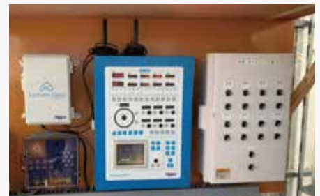
▲実証区に設置した「統合環境制御盤」
