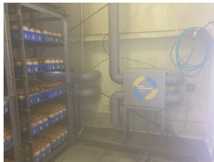
△熱交換器「SK-200」の設置現場（なめこ栽培）
